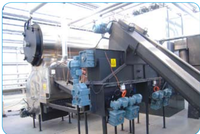
Swebo Biotherm Gen 3 brännaren 1000 kW med mixer och mellanförråd.
