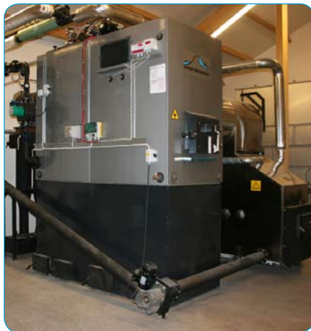
Pannan med Biotherm brännare och askurmatning från brännaren.
