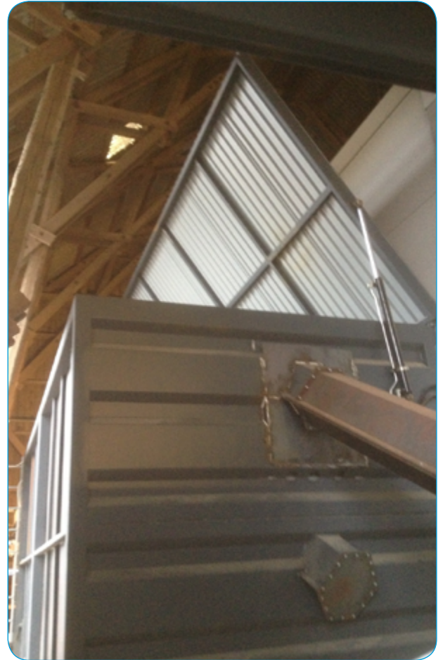
Efter klippning och mixning som sker automatiskt så skruvas materialet automatiskt till ett förråd.
