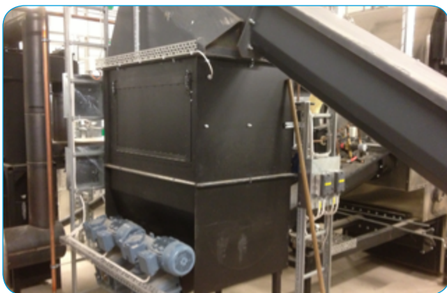
Från förrådet matas materialet till ett mellan-förråd.
