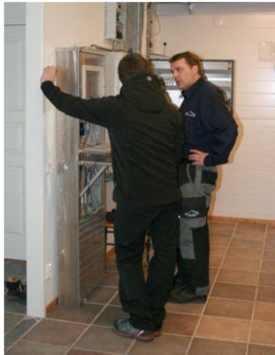
Anläggningen styrs av SWEBO FBR styrsystem.
