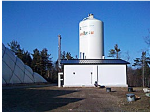
Värmecentral SWEBO PHC 1000 kW Pellets som värmer multisportarenan North Field.
